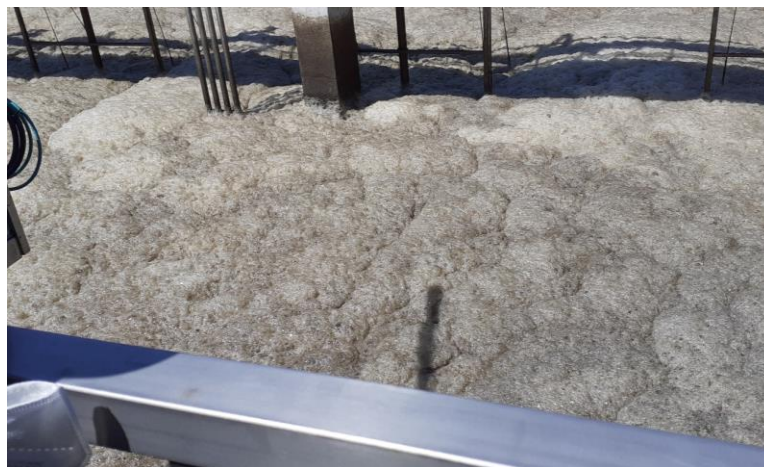
Efluente nitrificación-desnitrificación (NDN)
